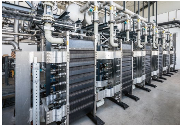
Grüne Wasserstoff-Pilotanlage, Foto: voestalpine
