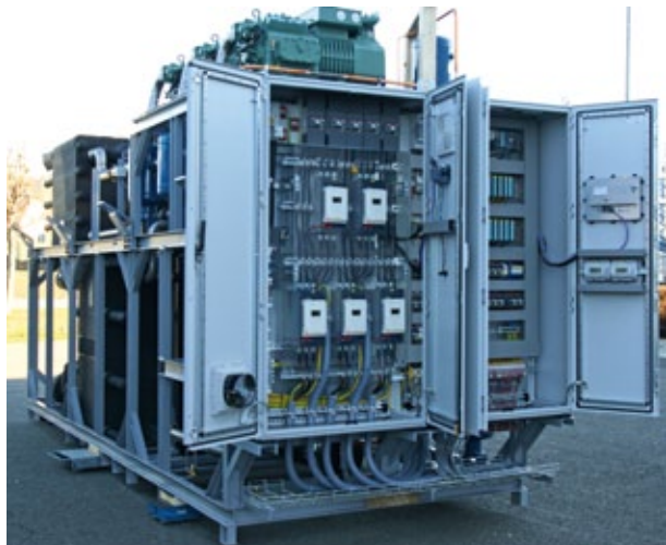
Foto: Frigopol Kälteanlagen GmbH
