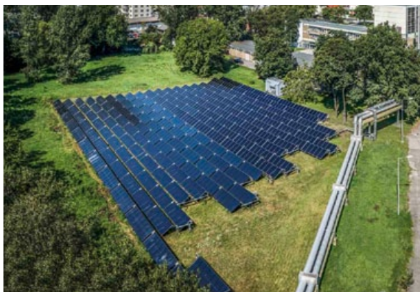
Foto: S.O.L.I.D. – Gesellschaft für Solarinstallation und Design mbH
